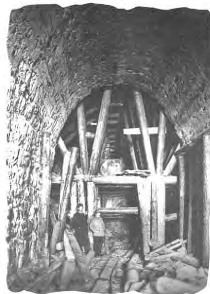
Строительство туннеля. Из 38 построенных туннелей лишь девять возведены с параболическим профилем. Из собрания Э. Каменщиковой
