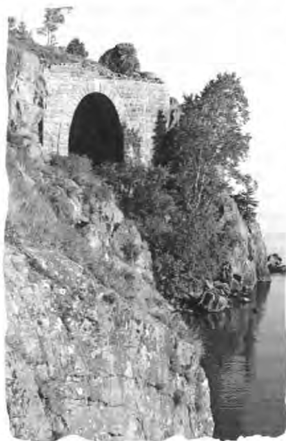
Восточный портал однопутной галереи № 6 сейчас обрывается в воду. В 1916 г. Березовский мост был перенесён отсюда на восточный берег Байкала
